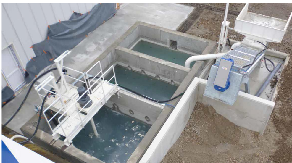
Slika 3.8. Bazeni za reciklažu (prečišćavanje) otpadne vode na betonari MEKA MB 110 K
