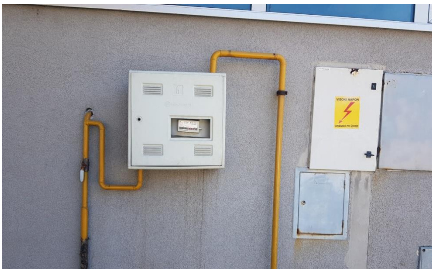
Slika 12. Plinska instalacija sa priključkom na gradsku mrežu
