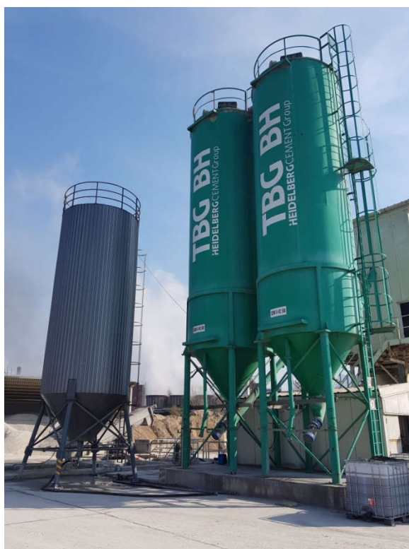
Slika 6. Silosi za cement
