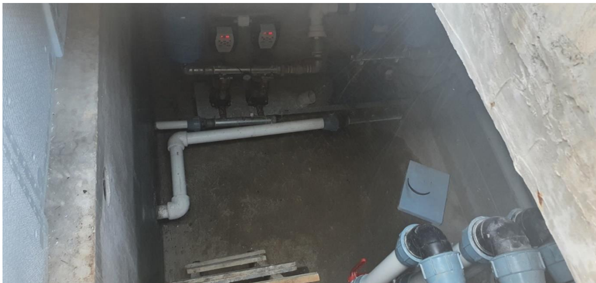
ILUSTRACIJA 16: PUMPNA STANICA ANAEROBNOG BIOLOŠKOG UREĐAJA ZA TRETMAN FEKALNIH I TEHNOLOŠKIH OTPADNIH VODA
